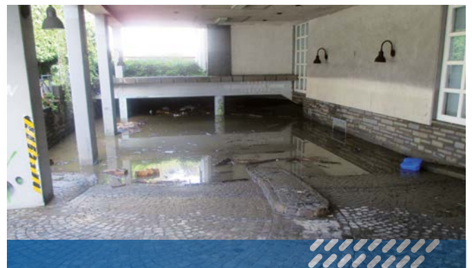
Abb. 14 b Vollgelaufene Tiefgarage ohne Bodenschwelle
